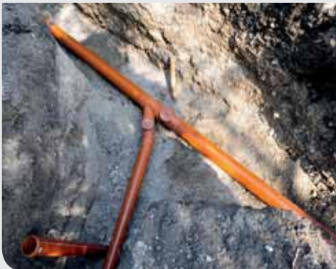
Sind die Abwasserleitungen wirklich dicht? Ein Radarsystem ermittelt Schwachstellen inner- und außerhalb der Rohre. © Karl Thomas/dpa
