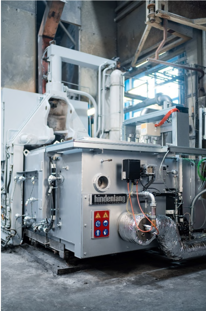
Abb. 1 Energieflexibilität in der Produktion: Bivalenter Tiegelofen reagiert lastflexibel mittels Energieträgerwechsel auf das Stromnetz ohne die Produktion zu beeinflussen.
