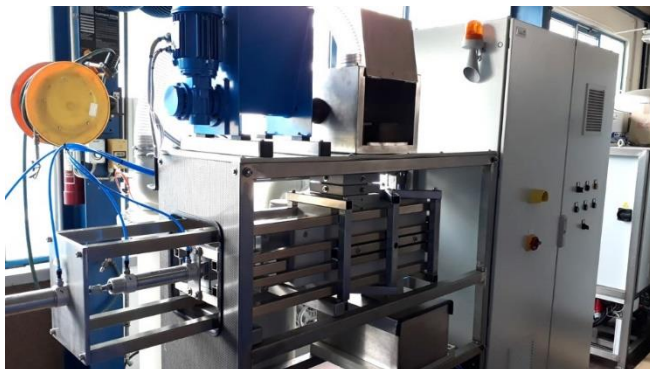
Abb. 2 Die Demonstrationsanlage zur Regeneration der Aktivkohlen.
